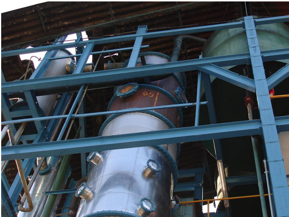
Figura 14B. Visão da coluna "2" do fornecedor "F1", mostrando detalhes de duas secções externas de cobre.
