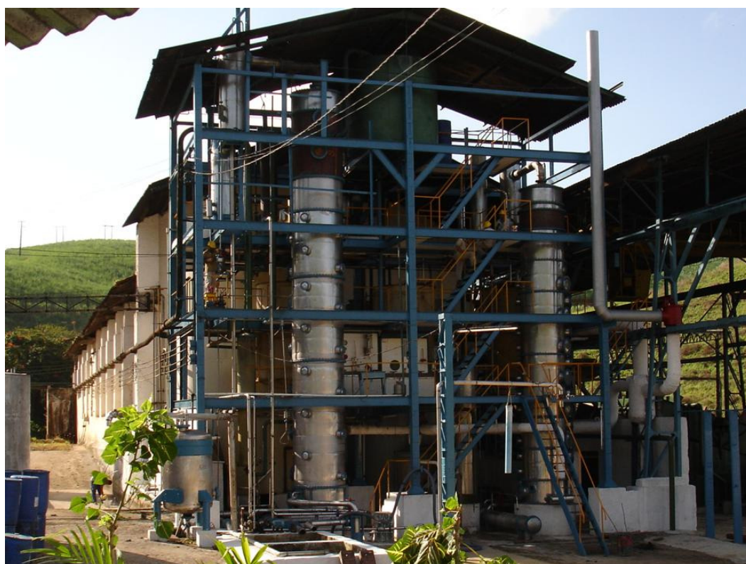
Figura 12B. Visão geral do fornecedor “F1”, mostrando a coluna “1” (à direita) e coluna “2” (à esquerda). Notar secções externas de cobre nas duas colunas (topo).
