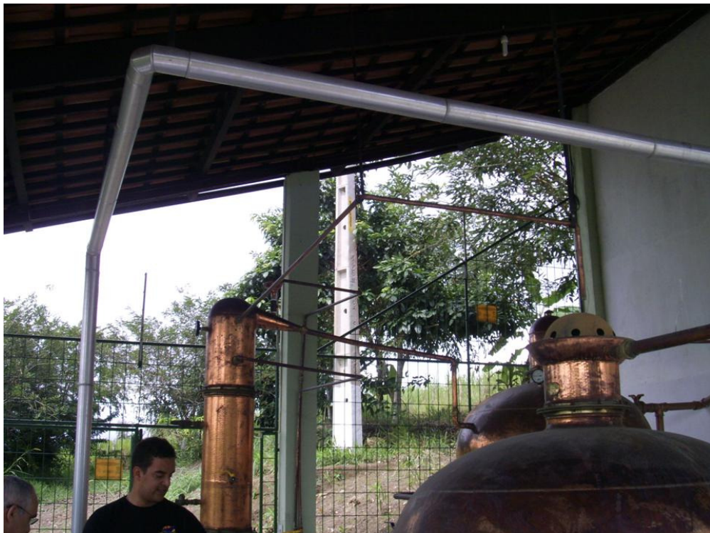
Figura 8B. Tubulação de vapor do estabelecimento “O”.
