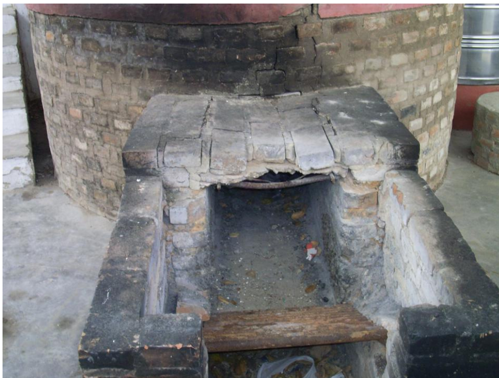
Figura 6B. Sistema de aquecimento (fogo direto) do estabelecimento “D”.
