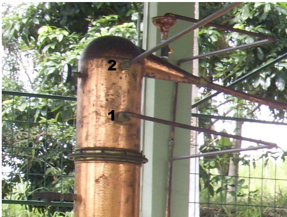
Figura 11B. Dispositivo de refluxo da coluna do estabelecimento “O”: (1) Entrada de água; (2) Saída de água.
